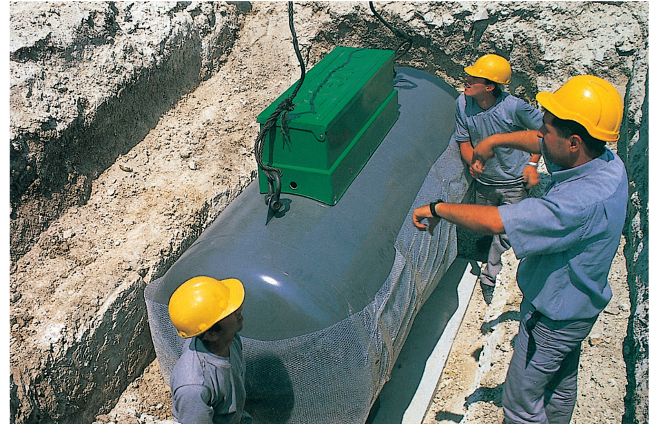
İzole edilmiş LPG Tankı ile toprakaltı uygulaması
